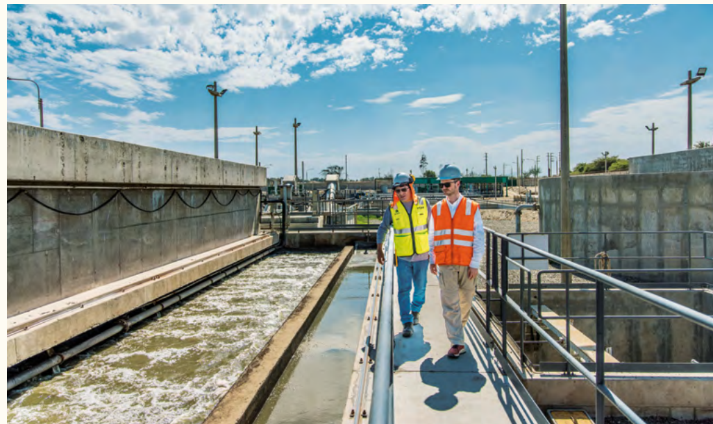
Waterzuiveringsinstallaties van onze partner Agrokasa in Peru
